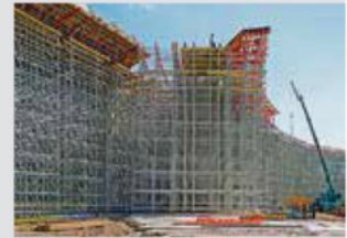
Shoring Systems 동바리 시스템
